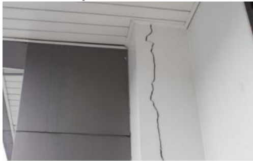
شكل (32) شرح و تشقق الجدار بجامعة حورس المصدر الباحث
